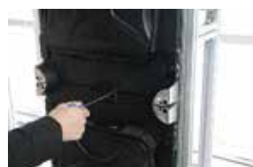
上下のパネル接続
